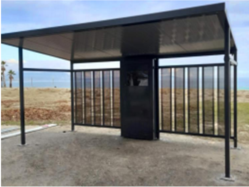
Εικόνα 18. Σταθμός φόρτισης ηλεκτρικών ποδηλάτων.
