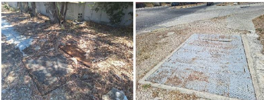
Προβλέπεται επισκευή μεταλλικού καλύμματος φρεατίου και επισκευή μεταλλικών καπακίων
